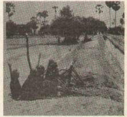
L'aspect de la campagne cambodgienne a complètement changé. Les terres arides sont devenues des rizières verdoyantes. Le problème de l'eau est résolu partout et il y a partout des rizières. La photo ci-dessus montre les travaux d'irrigation des rizières de la saison sèche 1975.
